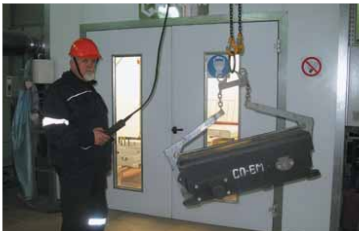
Старший электромеханик В.Н. Наумкин разгружает электропривод при помощи кран-балки
