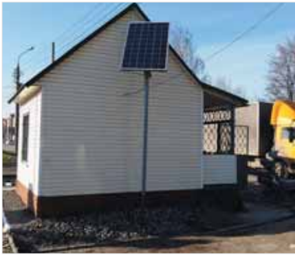
Солнечная батарея, установленная на переезде
