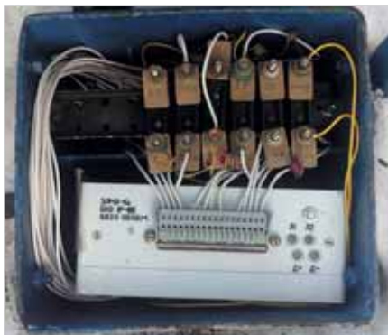
Аппаратура управления и контроля стрелочным электроприводом
