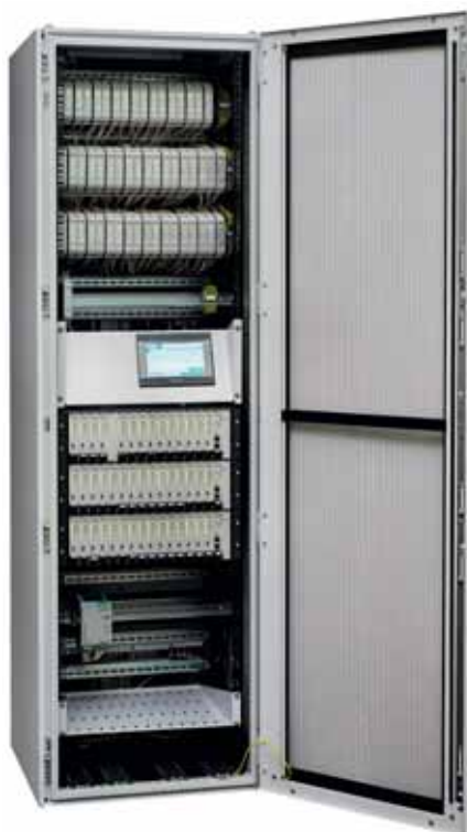
Постовое оборудование ЭССО-М
