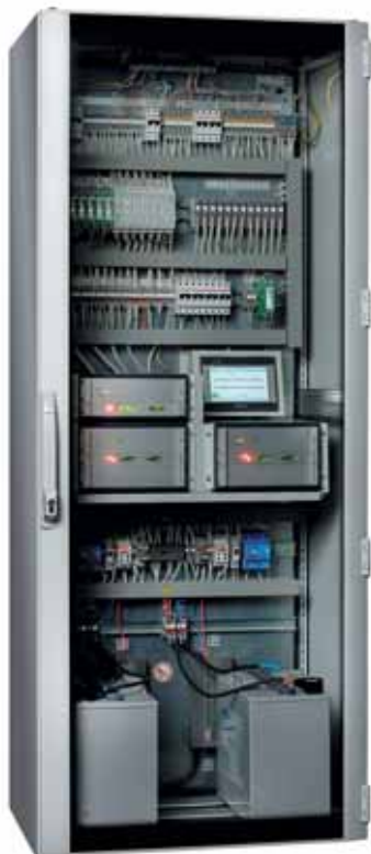
Оборудование безрелейной автоматической переездной сигнализации МАПС-М
