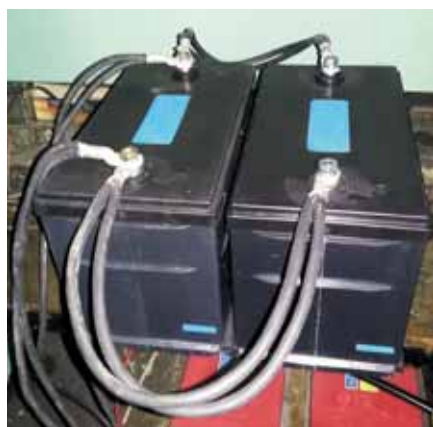
Конденсаторный модуль на станции Елец
