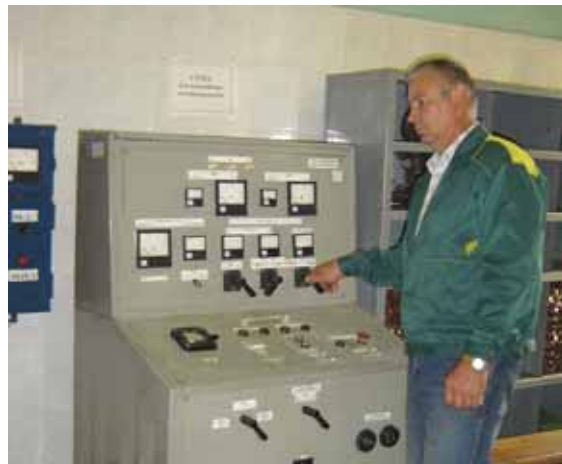
Старший электромеханик П.И. Калинович у стенда проверки электроприводов
