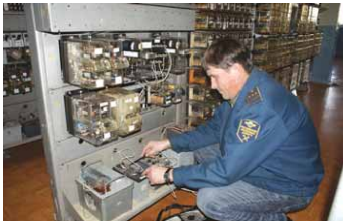
Старший электромеханик А.К. Куминов проверяет постовое оборудование
