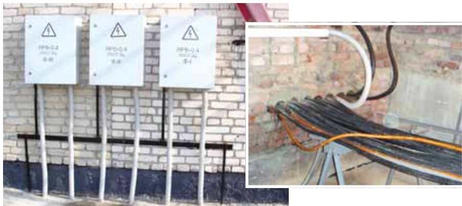
На вводах в помещения постов ЭЦ, а также между вводными разделительными ящиками и панелями питания силовые кабели отделены от кабелей СЦБ
