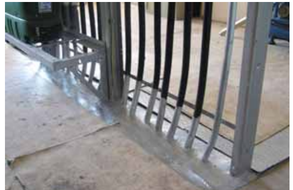
Ввод кабелей в помещение кроссовой надежно защищен от распространения огня
